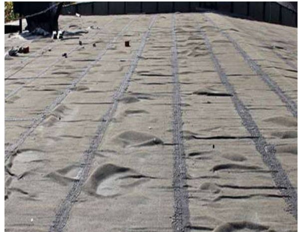
Рис. 1. Візуальний дефект покрівлі – здуття покрівельного килима
