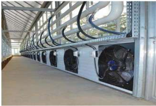
Рис. 2. Вентиляційний блок напівзакритої теплиці : зліва зовнішня стіна з «мокрими матрасами»; справа – стіна (перегородка) теплиці з вентиляторами на кожен ряд рослин, підвідними трубопроводами систем опалення, а також гнучкі рукави підключення нижнього (труборейкового) опалення
