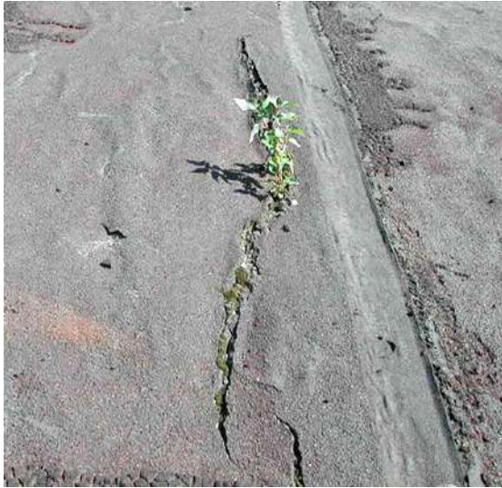
Рис. 4. Поява рослин та моху в тріщинах покрівлі
