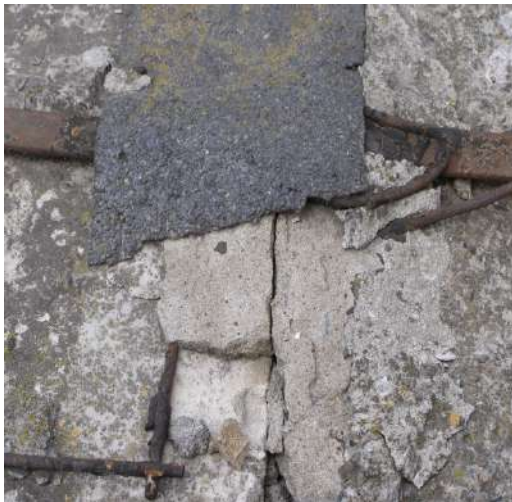
Рис. 5. Порушення ізоляції стиків між парпетними плитами
