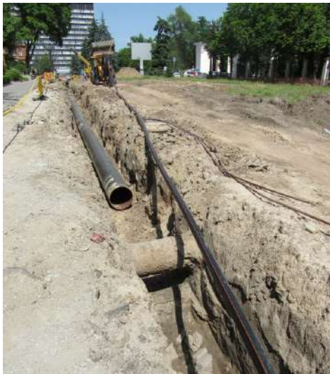
Рис. 10. Відсутній на схемах, однак виявлений під час земляних робіт фрагмент трубопроводу ймовірно зливової каналізації на площі Шевченка перед центральним входом у парк ім. Т. Г. Шевченка
