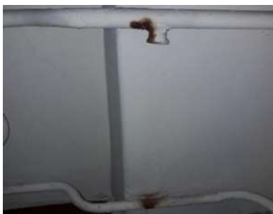
г) підтікання системи опалення
