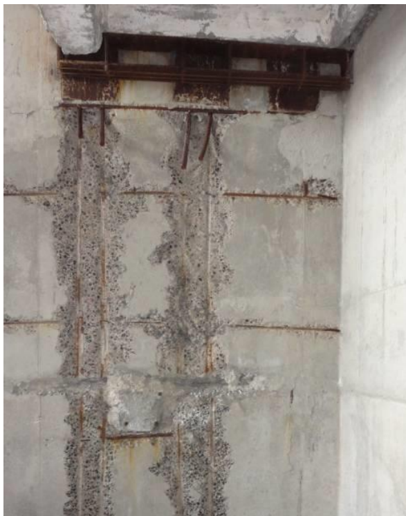
Рис. 3. Руйнування бетону конструкцій стін, вилучення арматури та корозія металевих конструкцій
