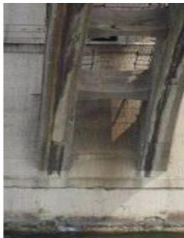
Рис. 3. Виявлені дефекти мостових споруд
