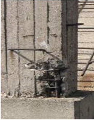
Рис. 2. Виявлені дефекти опор мостових споруд
