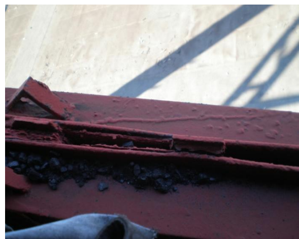
Рис. 3. Міжцилінна корозія виникла між парними кутиками розпірки вежі, що призвело до руйнування зварних швів
