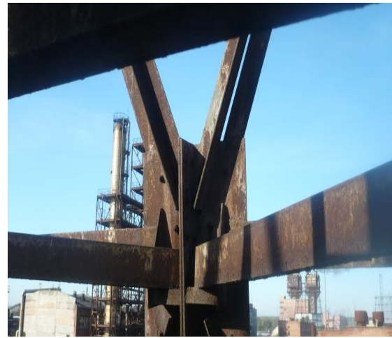
Рис. 2. Пошкодження захисного лакофарбового покриття, що перевищує 30 % загальної площі поверхні вежі
